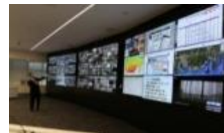
【テレビ会議システム(非常事態対策室内)】
