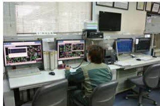
▲コントロールルームでの監視の様子
